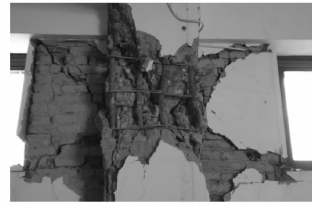
(b) C轴上1/3轴框架柱震害
