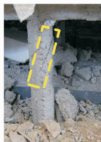
(b) 结构中柱出现贯通裂缝
