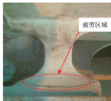
图 5 构架裂纹位置
