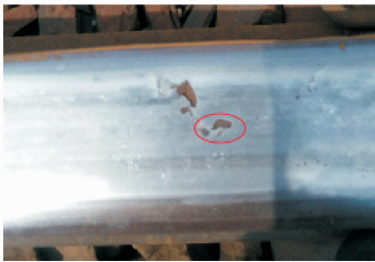
(b) 损伤的钢轨表面 (b) Actual track and defective surface
