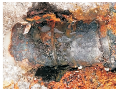
图 6 钢筋件的腐蚀程度
