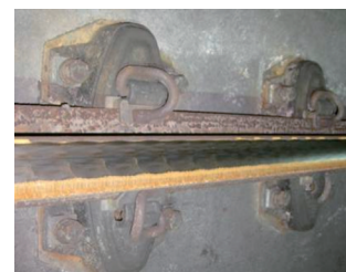
图2 波磨现场照片
