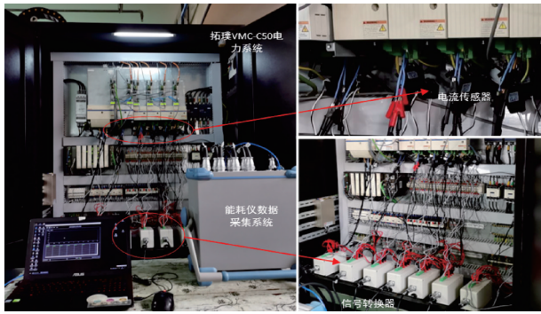
图6 能耗仪测试系统现场布置
