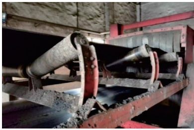
图10 托辊辊轴老化、锈蚀严重
