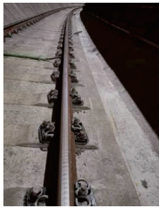
图1 内轨波磨照片
